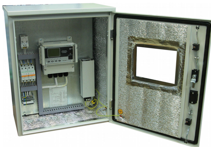
б) Шкаф в открытом состоянии
